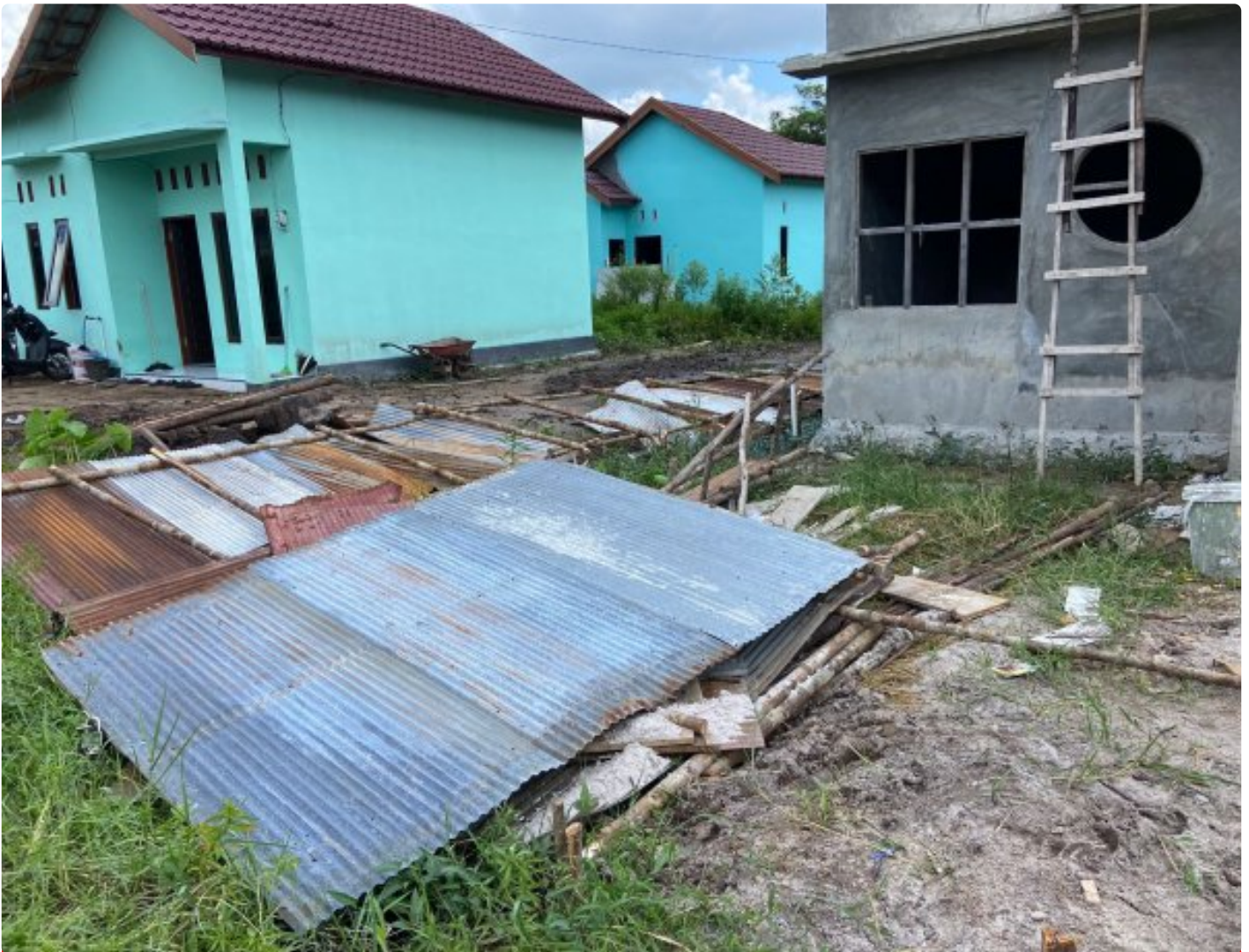
Gambar: Kondisi Pagar Seng Yang Dirusak Oknum
